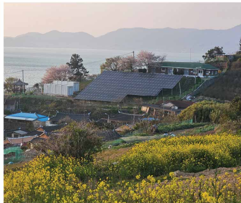
▲ 하화도에 설치된 국내 최초 섬 태양광발전소
